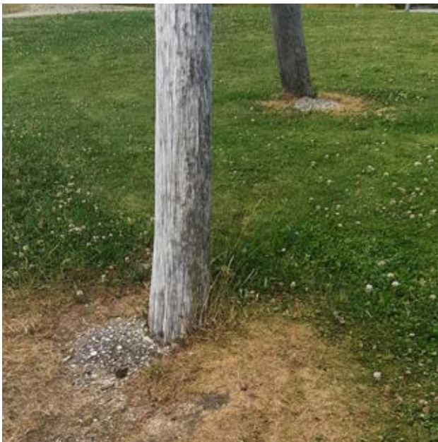
Dieses Fundament wurde nicht tief genug gesetzt.
